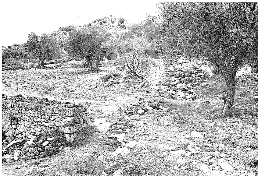
Fig. 10 — Troço do 1.º paredão (à direita) bastante danificado. À esquerda início da sua estreita continuação, em curva de nível.
